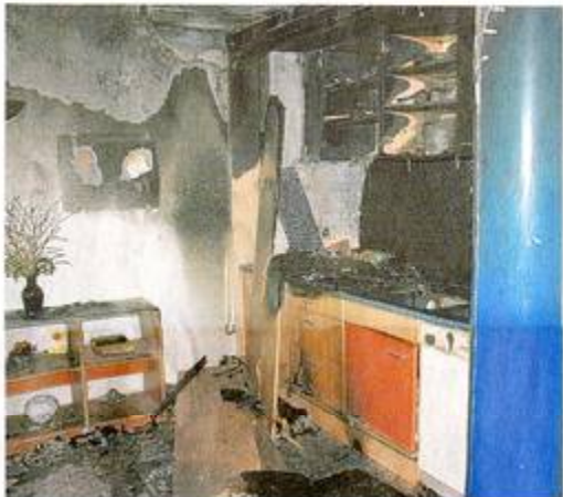
Blick in die Teeküche. Der Brand ging offenbar vom Herd aus. Allerdings lag kein technischer Defekt vor.
