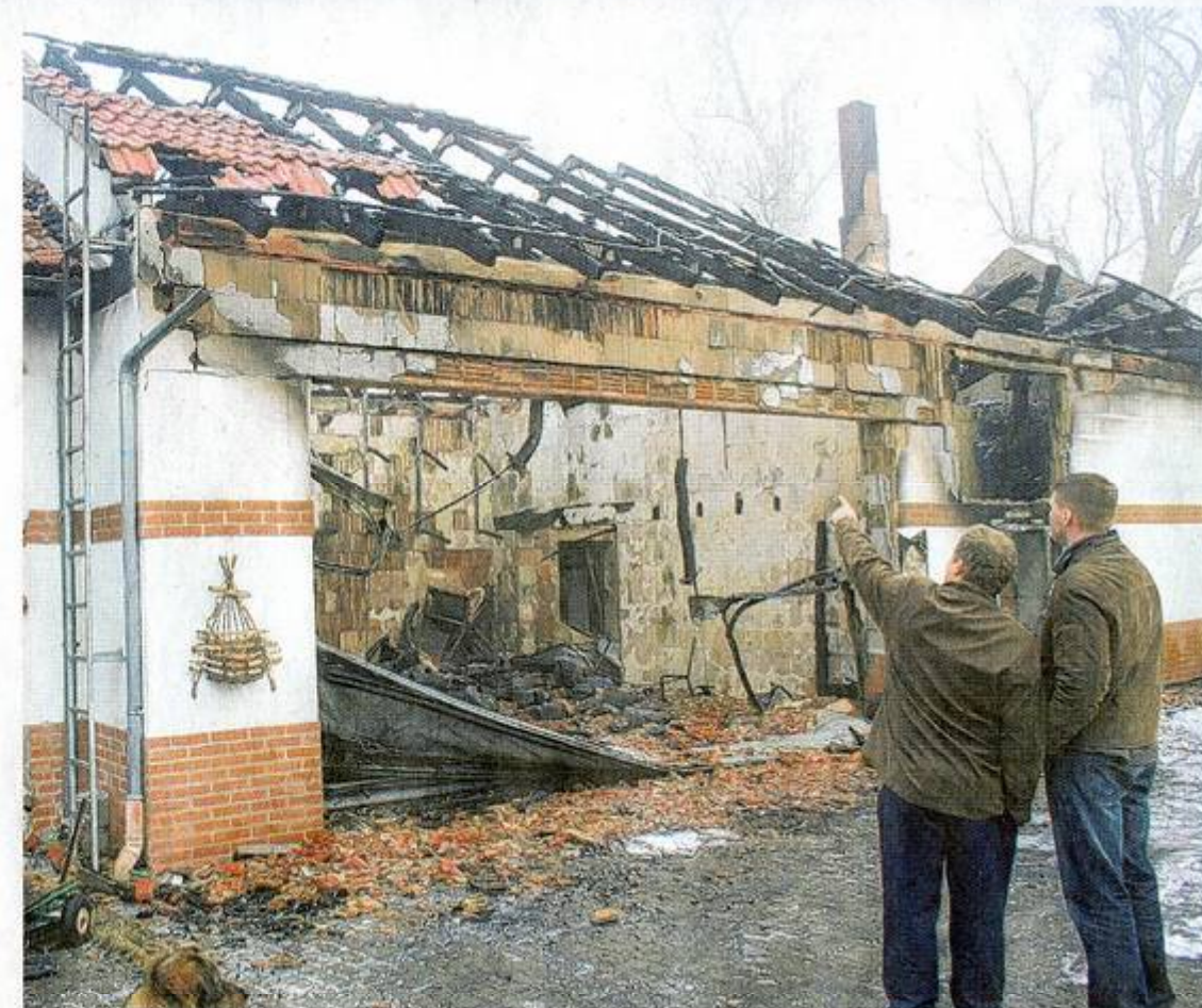
Am Tag nach dem Brand wird das ganze Ausmaß des Unglücks auf dem Hof Klinger sichtbar. Völlig ausgebrannt sind Garage und Heizhaus. FOTO: F. LUCIUS
