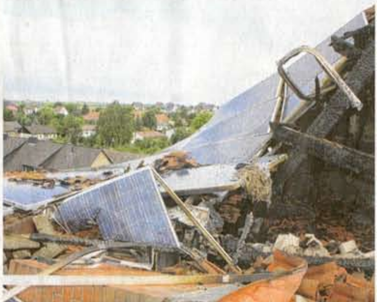
Das Dachgeschoss ist komplett zusammengebrochen. Erst im Herbst war dort eine Photovoltaikanlage montiert worden.
